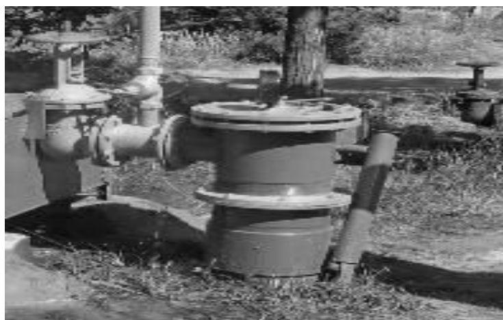
Рисунок 3. – Водозаборная скважина, оборудованная для эксплуатации по новой технологии
