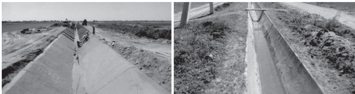
Рис. 2. Бетонированные и лотковые оросительные сети
