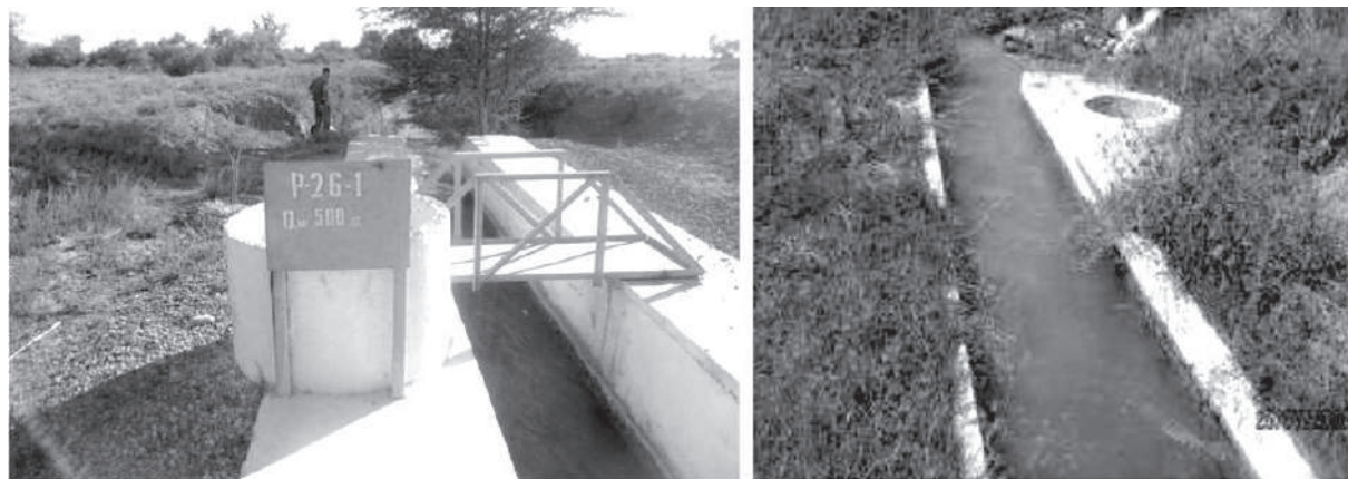
Рис. 3. Водомерное устройство на участковых каналах
